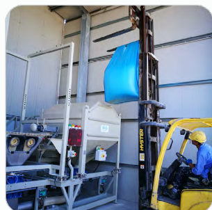
IMPIANTO DI SCARICAMENTO BIG BAGS
