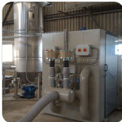
POMPA VUOTO E CICLON FILTRO DI RICEVIMENTO
