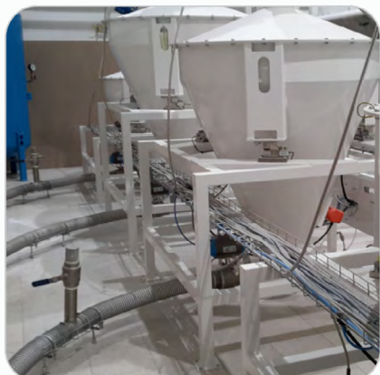
BATTERIA DI TRAMOGGE PESATE DI CARICAMENTO
